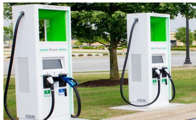
Estación de carga (energía eléctrica)
