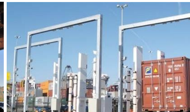
Automatización para los accesos del autotransporte y salida de contenedores
